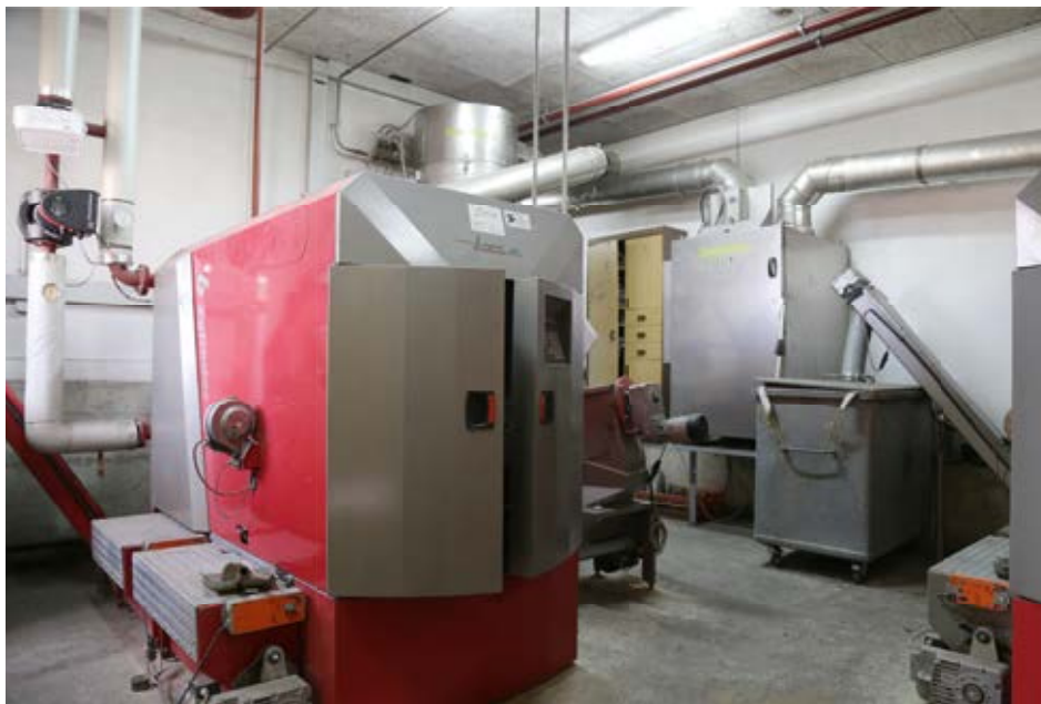
Fast kein Feinstaub: Hackschnitzelkessel mit Feinstaubfilter
